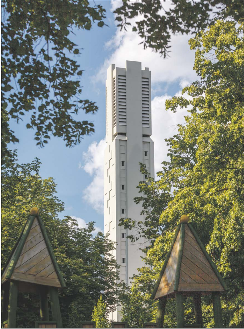
▲ Die Kirche Zwölf Apostel wurde 1967 feierlich geweiht. 2009 wurde der 42 Meter hohe Turm einer umfangreichen Betonsanierung unterzogen. Fotos: Banner
