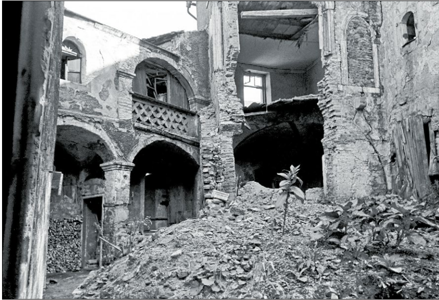
▲ Die im frühen 14. Jahrhundert errichtete Dorotheenkapelle am Frauenbergl 4 wurde ebenfalls am 20. Oktober 1944 von einer Bombe getroffen. Das Bild zeigt den Blick auf die eingestürzte Westwand und auf den Rest des gotischen Kapellengewölbes im Erdgeschoss. 1953/54 wurden die Kapelle und die angrenzende ehemalige Domherrenkurie abgebrochen, nur die Fassade blieb stehen und wurde für den Neubau eines Bürohauses wiederverwendet. Foto: Stadt Regensburg, Bilddokumentation/Christoph Lang
