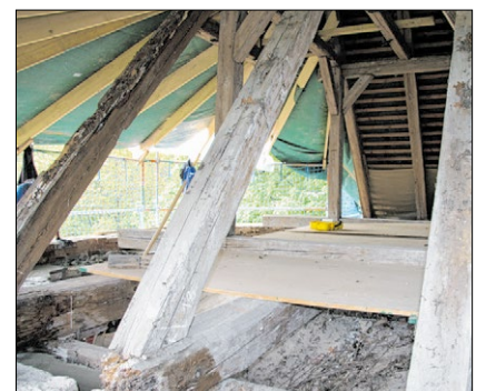
▲ Erschreckende Schäden im Dachstuhl erforderten weitreichende Maßnahmen. Foto: Wimmer
