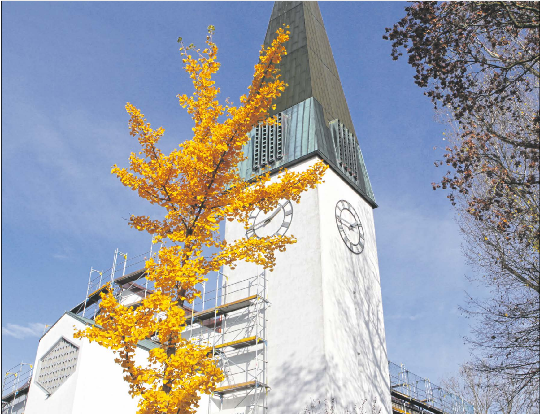
▲ Die Christkönig-Kirche in Augsburg-Hammerschmiede musste 2014 wegen Mängeln an der Holzleimbinder-Konstruktion des Dachs geschlossen werden. Nach einer stützenden Inneneinrüstung waren wieder Gottesdienste möglich. Derzeit werden Sanierungsarbeiten ausgeführt. Die Kirche wurde 1963/64 nach Plänen des Architekten Karl Sendlinger errichtet. Der Chorraum wurde 1992 umgestaltet. Foto: Zoepf
