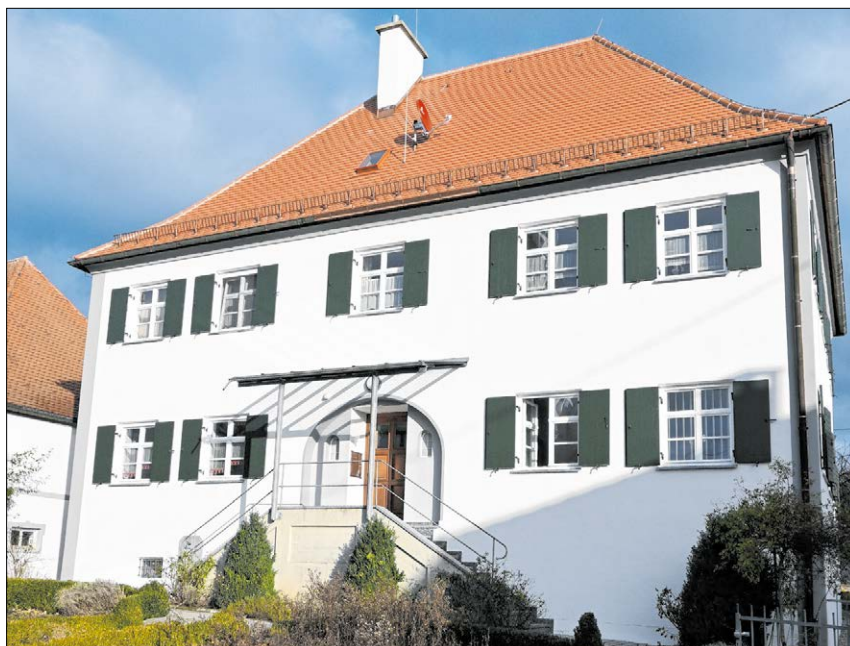
▲ Am Pfarrhof in Münsterhausen wurden aus Gründen der Standsicherheit der Dachstuhl erneuert und das Dach neu gedeckt. Fotos: Gah
