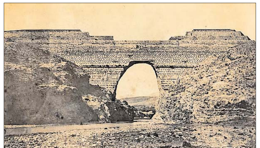
▲ Infolge starker Regenfälle entstand ein großes Loch in der Talsperre von Puentes. Sie sah dadurch wie eine Brücke aus. Ursache war ein Baufehler.
