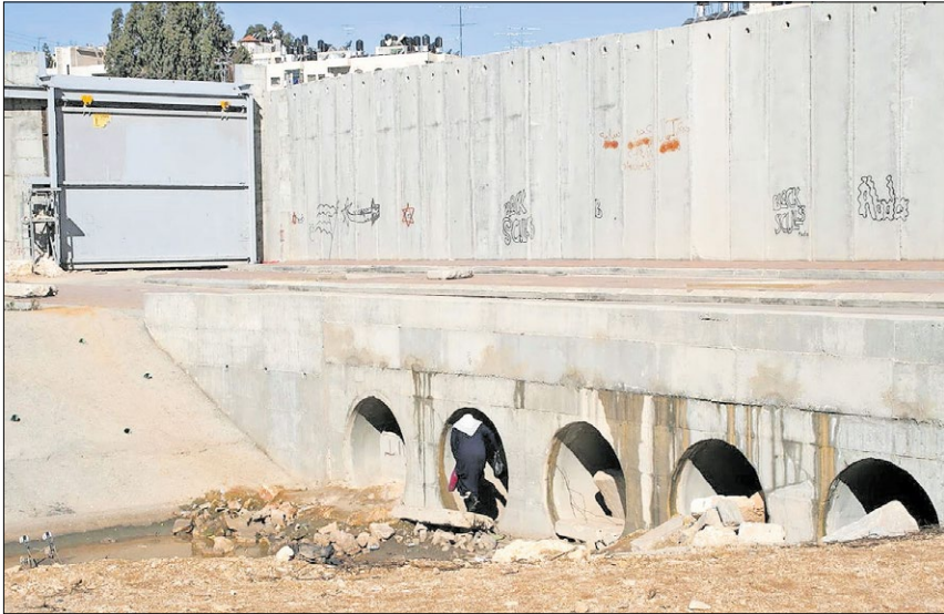
▲ Die Mauer ist durchlässig – zumindest über die Abwässerkanäle darunter.
