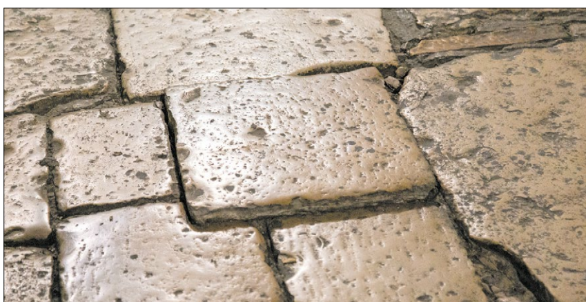
▲ Der Boden der Grabeskirche ist an zahlreichen Stellen uneben. Bei den laufenden Arbeiten soll er daher restauriert und trittsicher gemacht werden.
