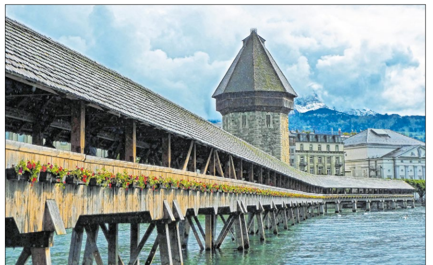
▲ Nach dem Brand wurde die Luzerner Kapellbrücke umgehend wiederaufgebaut. Am 14. April 1994 wurde sie eröffnet und für die Benutzung durch Fußgänger freigegeben.
