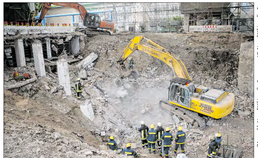
▲ Fehler beim Bau der U-Bahn waren wohl die Ursache dafür, dass vor zehn Jahren das Kölner Stadtarchiv einstürzte. Zwei Menschen starben.
