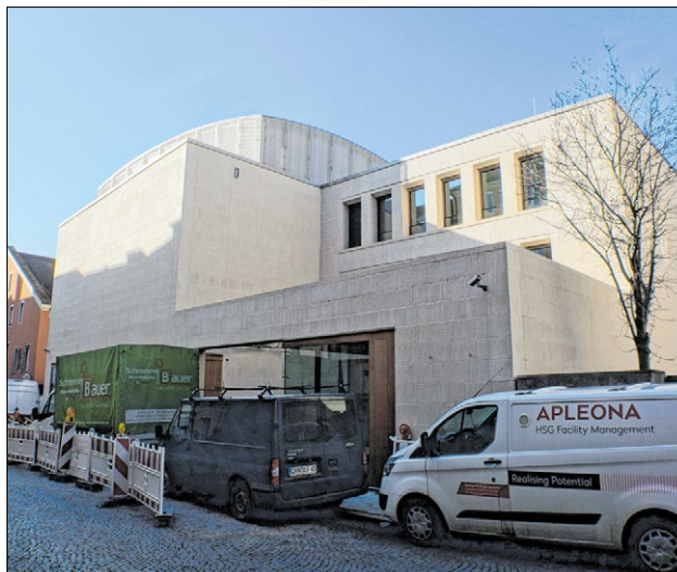
▲ Noch ist die neue Synagoge eine Baustelle, doch am Eröffnungsdatum 27. Februar wird nicht gerüttelt. Foto: Mohr
