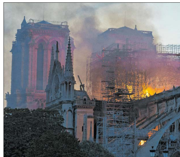
Bei Renovierungsarbeiten brach am 15. April auf dem Dach der Pariser Kathedrale Notre-Dame ein Großfeuer aus, das den Vierungsturm, Dächer und Dachstuhl sowie Teile der Gewölbe zerstörte. Die Wiederherstellung wird hunderte Millionen Euro kosten und noch viele Jahre dauern.
